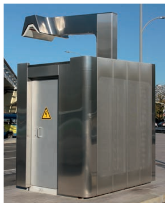
Зарядные станции для электробусов
